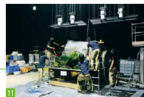
Die Wände werden an die Aquarien gebaut - der schwierigste Teil! Als der Hauptteil angehoben wird, macht sich Nervosität breit.
